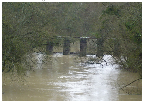
Ouvrage "anti-retour" sur la Cisse
